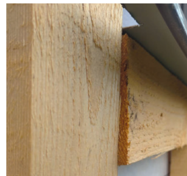
Обрешетка не в плоскости. Перекрыт вентиляционный канал.
